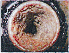
築40年の浴室排水管の 固着したスケール
