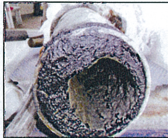
築40年 排水管 共用縦管スケール
